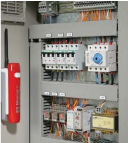
Het lokale blussysteem geplaatst in een meterkast.
