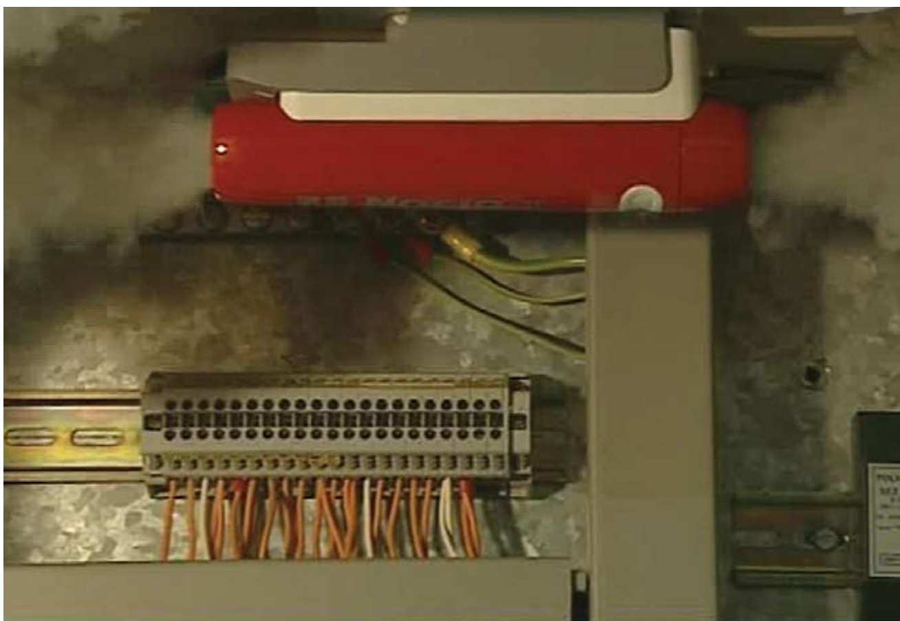
Het NOFIQ-brandveiligheidssysteem zorgt ervoor dat een beginnende brand in een afgesloten compartiment snel wordt geblust.
